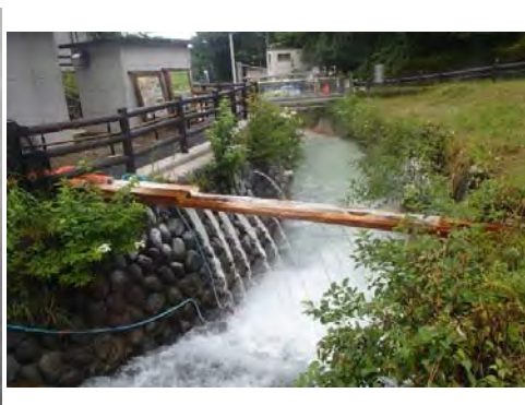
【中和を止めるな！～工事中も仮設で中和～】 撮影者会社名・撮影者：成和リニューアルワークス(株) 池田恭輔
