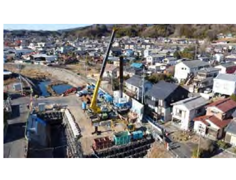
【鋼管杭を回転切削圧入中。】 撮影者会社名・撮影者：前橋地建(株) 堀電弘幸
